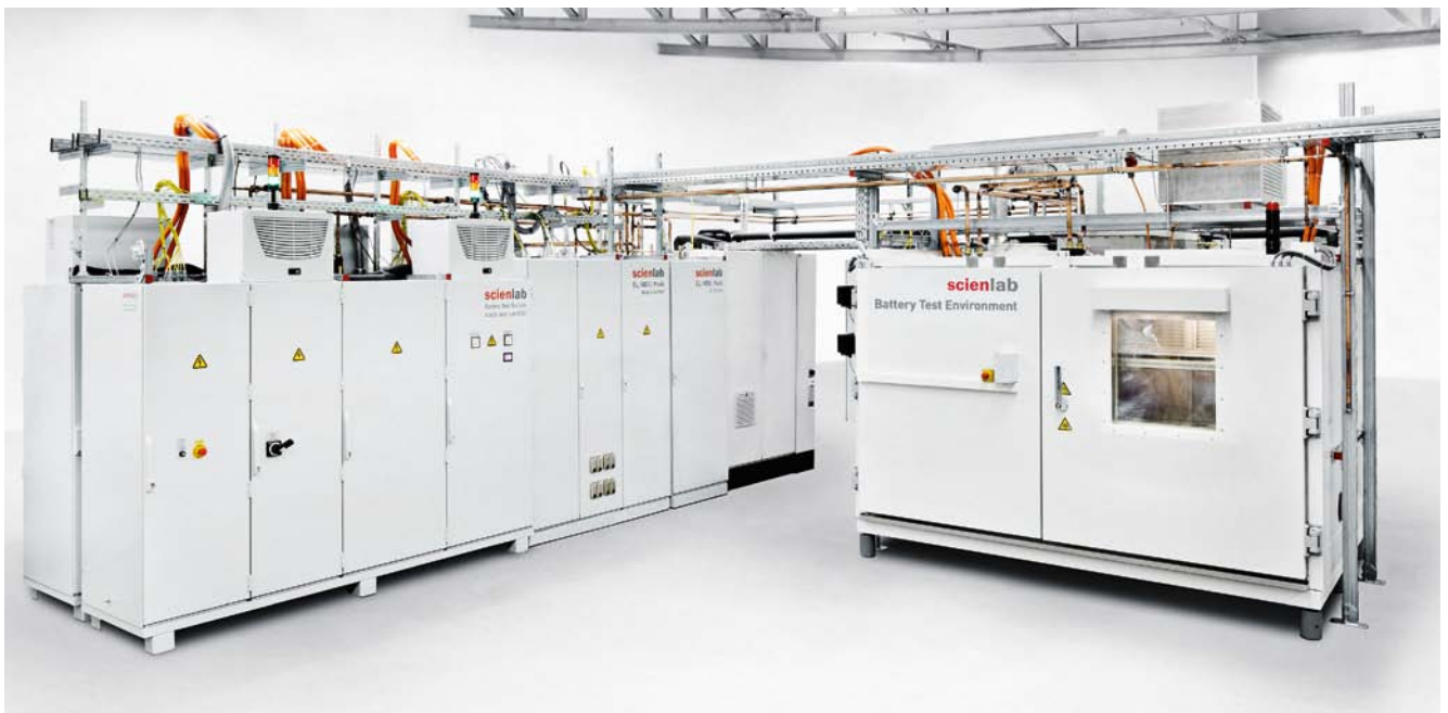
Scienlab Testlabor zur Validierung von Batteriepacks
